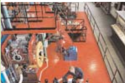
CHAUFFERIE DU CHR DE LILLE
